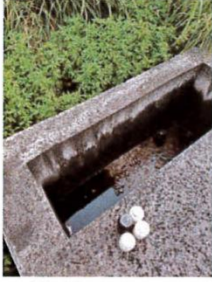
生活污水处理设施 进水口
