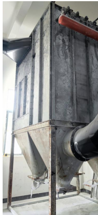
图 2 布袋除尘器(3#、4#混合搅拌)
