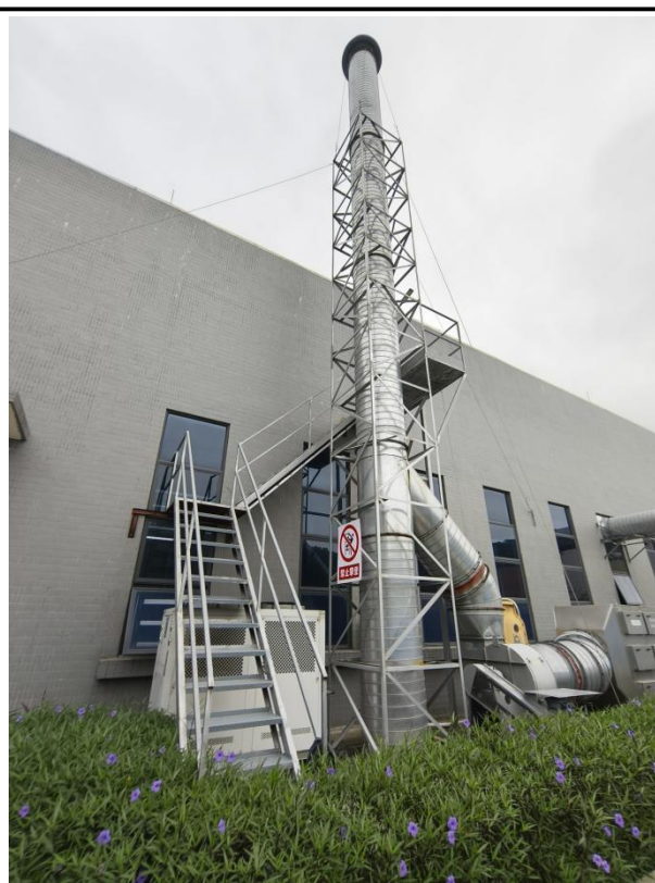
图 2 排气筒 DA002 及采样平台
