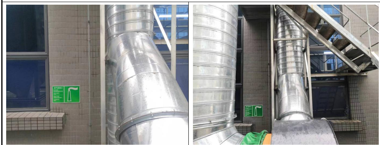
图 8 投料搅拌工序废气排放口 DA009 标识牌（近、远）
