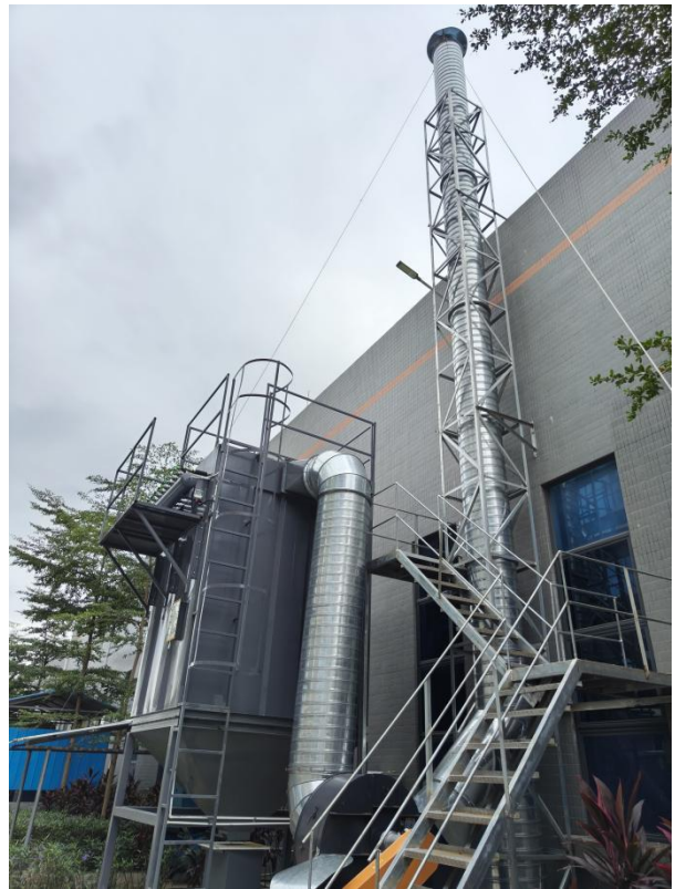
图 4 排气筒 DA009 及采样平台
