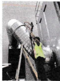
投料搅拌粉尘废气 DA009 处理前
