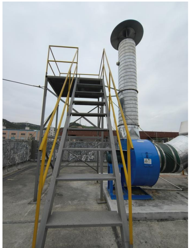
图 6 排气筒 DA010 及采样平台
