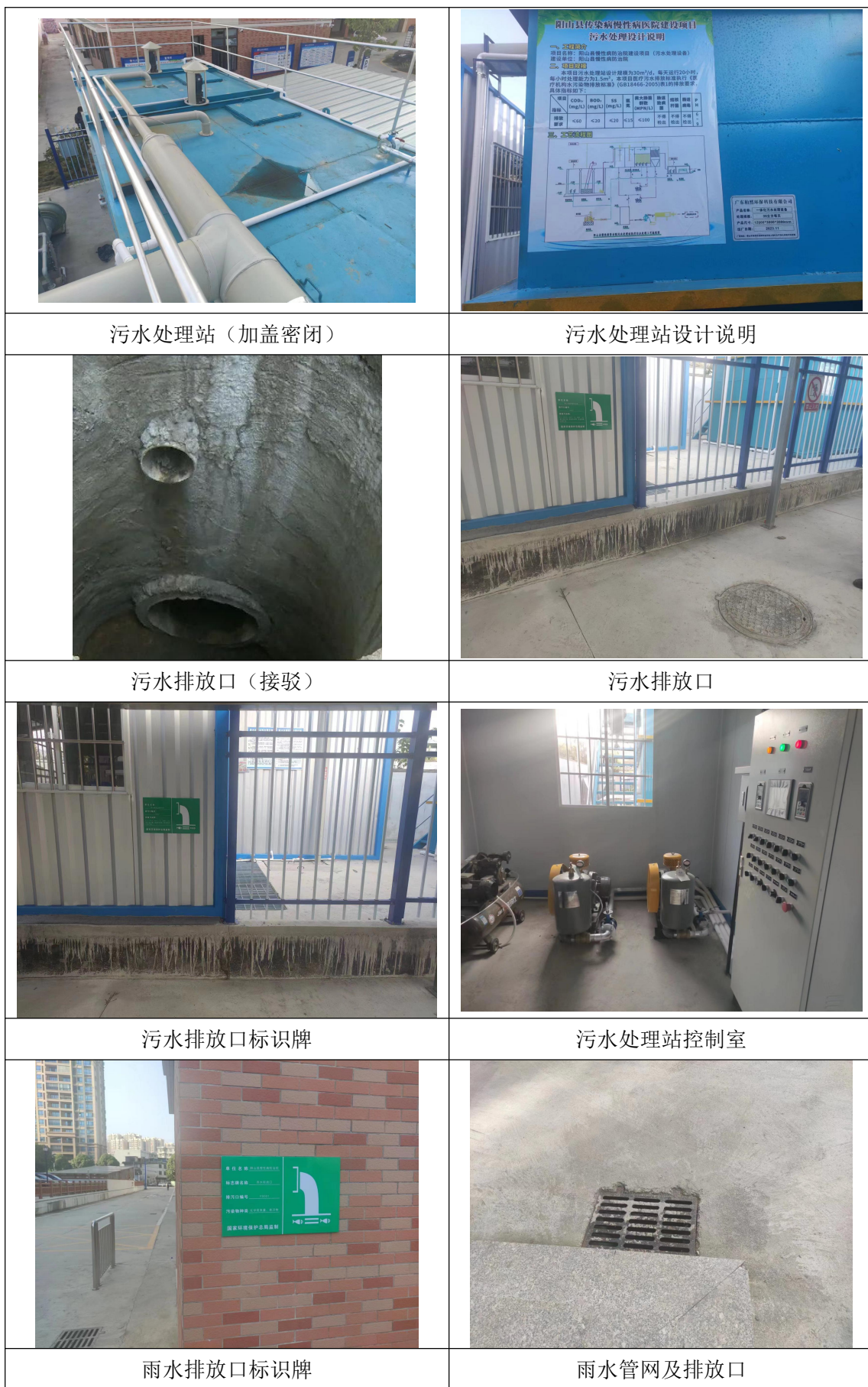
图 3.5-1 院区废水环保处理设施图
